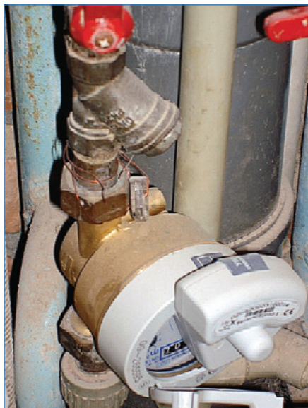
Рис. 1. Водомерный узел в квартире
